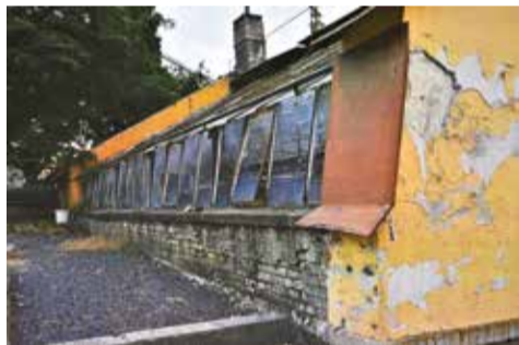
Skleník byl v tak špatném stavu, že do něj ředitel školy musel v roce 2022 zakázat vstup. Foto TGA
