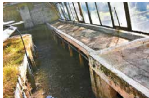
Pohled do vnitřních prostor skleníku. Po 160 letech provozu byl v dezolátním stavu. Foto TGA
