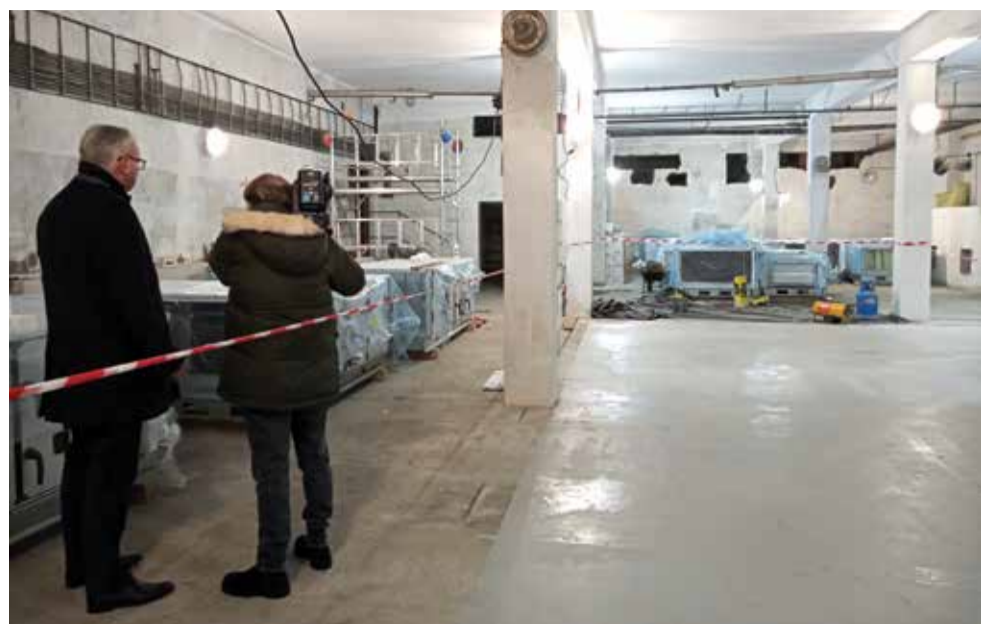
Ředitel nemocnice Petr Hossner v podzemních prostorách strojovny vzduchotechniky. Foto M. Šil
